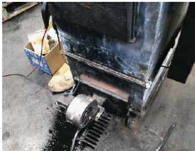
Piec, w którym właściciel spalał olej silnikowy
