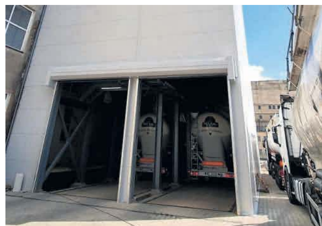
W PZZ trwa budowa bezobsługowej spedycji otrębowej
