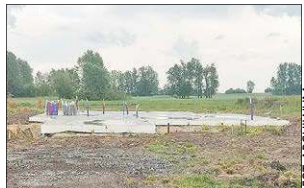
Firma Mark-Bud brała zaliczkę na pierwszy etap budowy, zazwyczaj wylewała fundament. Następnie zaczynały się problemy z dokończeniem budów
