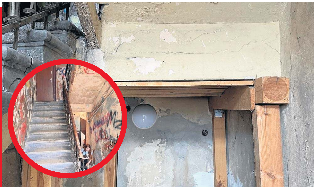
Tak wygląda klatka schodowa w kamienicy przy ul. Limanowskiego 13. Stropy podparto drewnianymi belkami.
