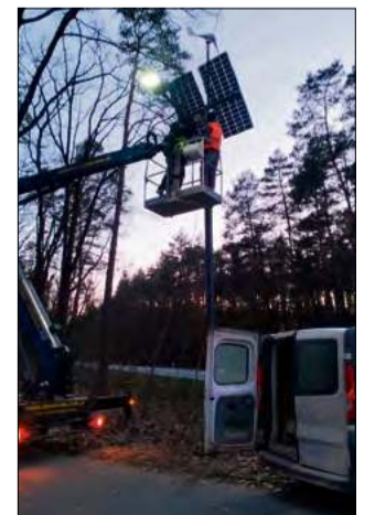
Oświetlenie wyróżnia się nowoczesnymi rozwiązaniami technicznymi.
