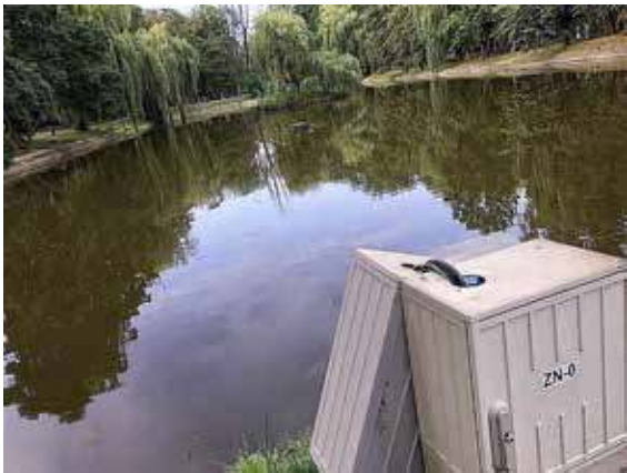
W lipcu zniszczono zasilanie fontanny fot. arch.
