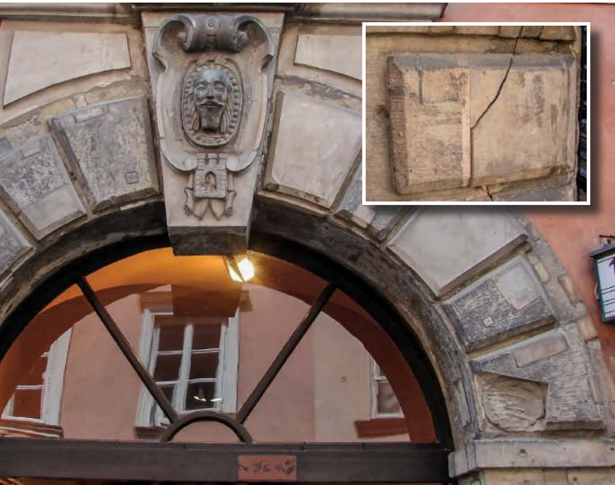
Portal kamienicy przy ul. Piwnej 13 i jego fragment z widocznymi pęknięciami | fot. Janusz Sujecki/Gazeta Polska
