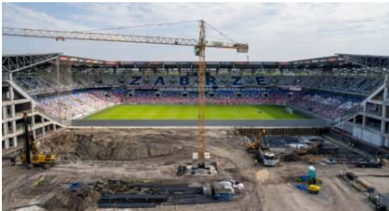
► Na budowie zachodniej trybuny Areny Zabrze trwają intensywne prace Fot. UM Zabrze
