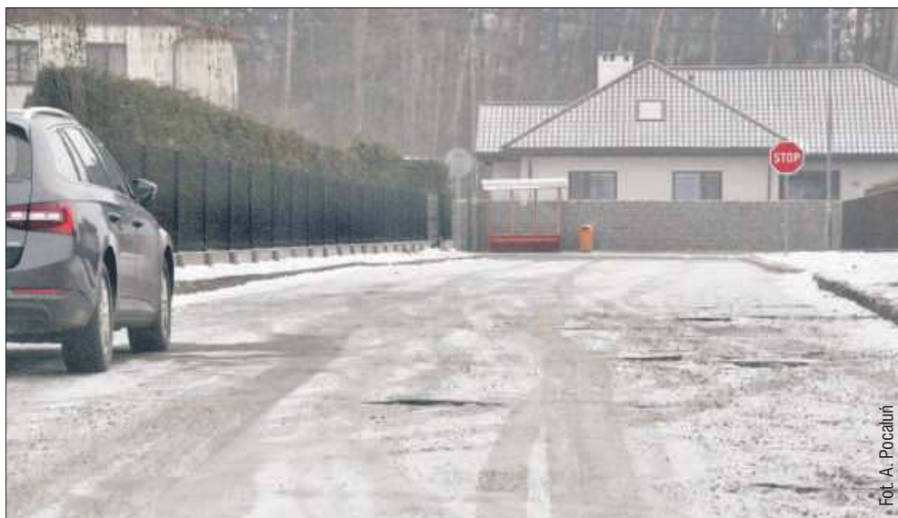
Osiedlowa droga ma coraz więcej dziur.
