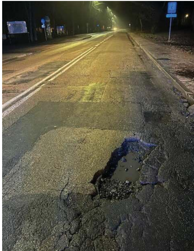
Stan nawierzchni na ul. Ledóchowskiego pozostawia wiele do życzenia
