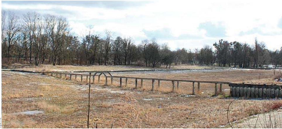
Basen przy ul. Spacerowej został zamknięty w 2012 r. po interwencji sanepidu w sprawie zanieczyszczonej wody. Od tamtego czasu obiekt niszczy
