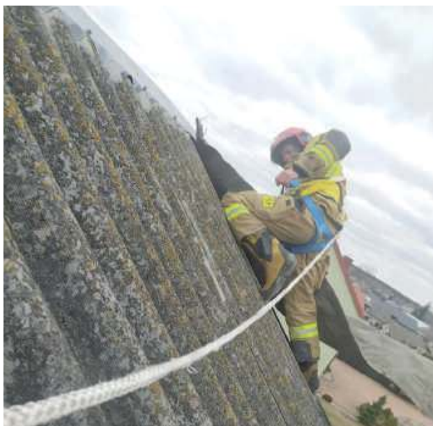
GMINA STANIN Uszkodzony dach w Zastawiu na piętrowym domu. Strażacy z OSP Stanin, OSP Jedlanka i PSP Łuków zabezpieczyli miejsce i wyгородzili teren, a następnie, ubrani w specjalne uprząże do pracy na wysokości, przystąpili do naprawy i załatwienia poszycia. Wiatr uszkodził dach w sobotę 19 lutego ok. godz. 9 rano. Strażacy zabezpieczyli też zerwaną linię energetyczną, do jej naprawy przyjechało Pogotowie Energetyczne
