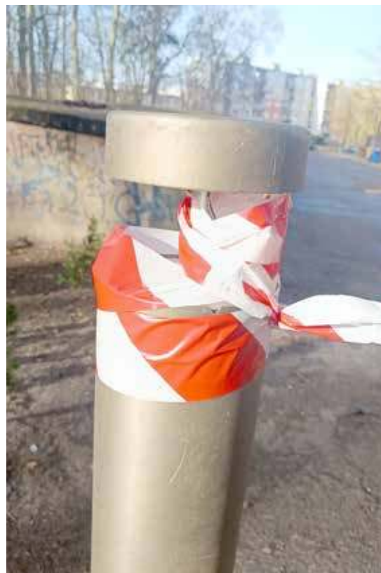
Duża część uszkodzonych lamp już od dłuższego czasu oznaczona jest białą-czerwoną taśmą
