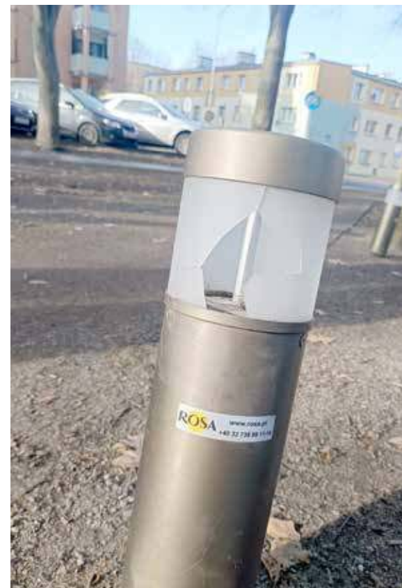
Nie wszystkie uszkodzenia są oznaczone
