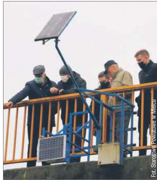
Podczas odbioru technicznego monitoringu powodziowego.
