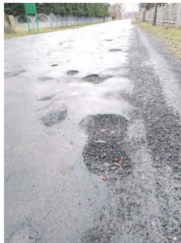
Nawierzchnia wymaga pilnego remontu
