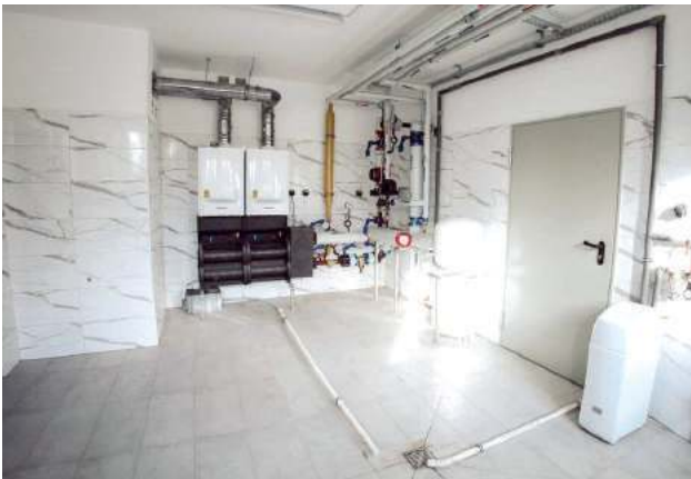
Modernizację przeszła również kotłownia
