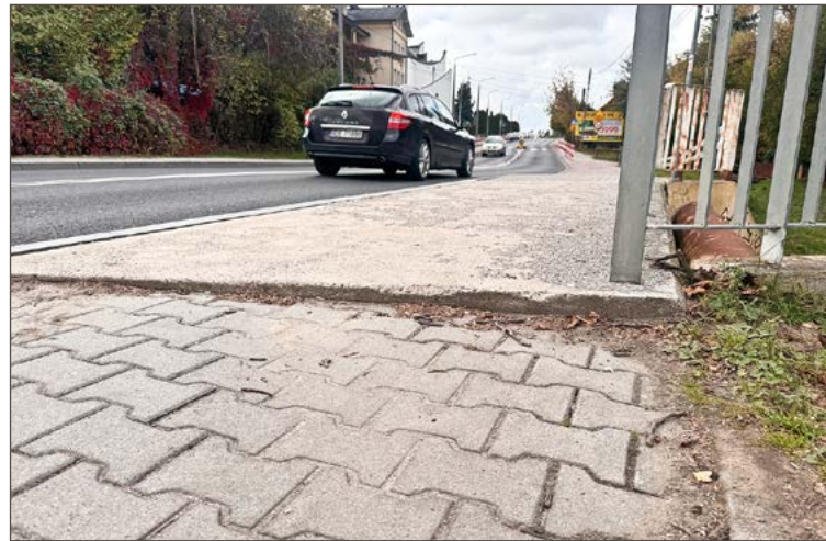
Wjazd na mostek dla wózków może stanowić przeszkodę.
