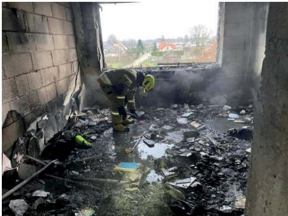
W pokoju, w którym wybuchł pożar, odpadł tynk ze ścian (fot. OSP Krzywda)
