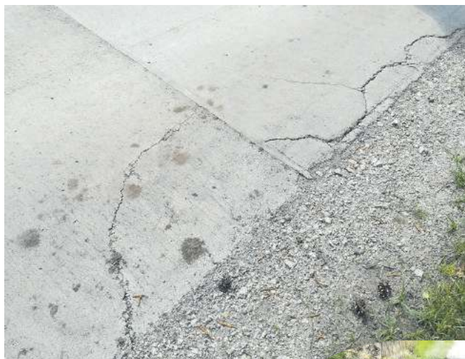
Nawierzchnia ścieżki jest popękana
