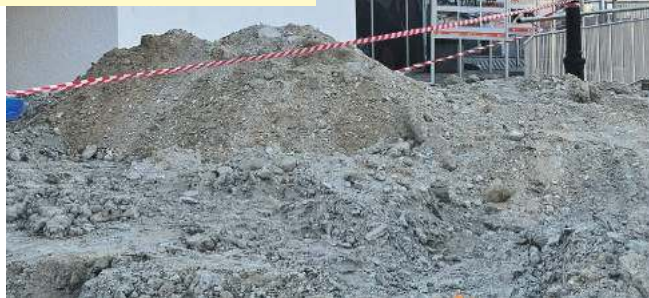
Hałdy ziemi i piachu zalegają przed wejściem do hali
