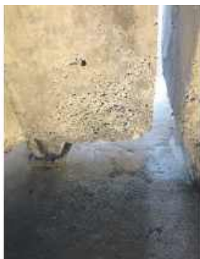
40. Zawilgocenia oraz rozsegregowanie mieszanki betonowej płaszcza betonowego dźwigara w strefie zakotwienia kabli srozeżaiacvch.
