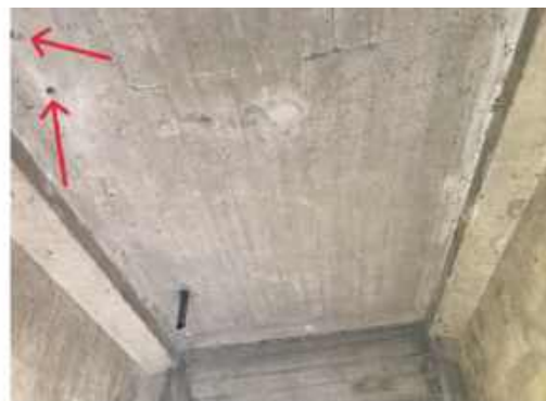
41. Odspojenia otuliny betonowej płyty pomostu, widoczne skorodowane zbrojenie oraz wylugowania wabienne.
