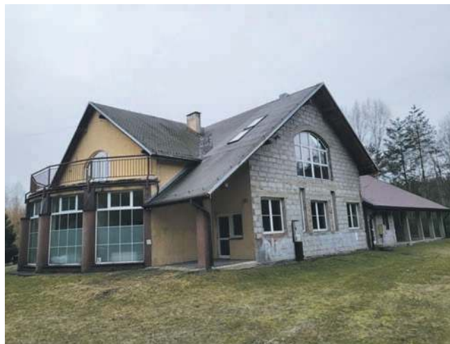
Przez wiele lat, choć budynek był użytkowany, to cały czas czekał na porządny remont, a właściwie na zakończenie inwestycji
