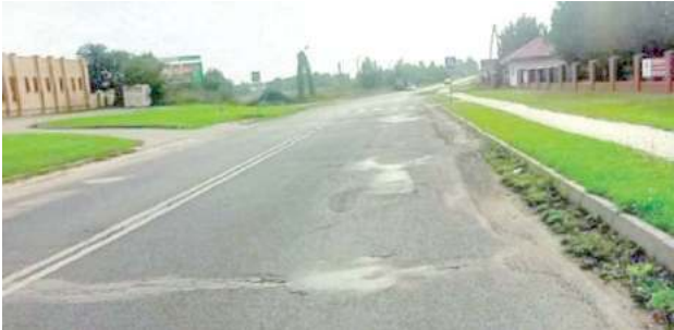
Chodzi o odcinek będący w kiepskim stanie
