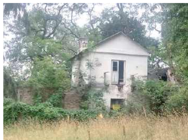
Dworek wybudowany dla cara Rosji jest w fatalnym stanie
