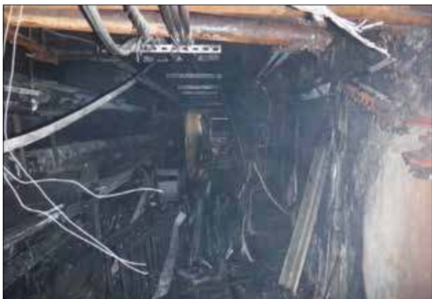
To obraz rozmiaru zniszczeń, jakie poczynił pożar, który wybuchł w przejściu technicznym łącznika między szpitalem głównym a Centrum Chorób Zakaźnych i Ftyzjopulmonologicznych
