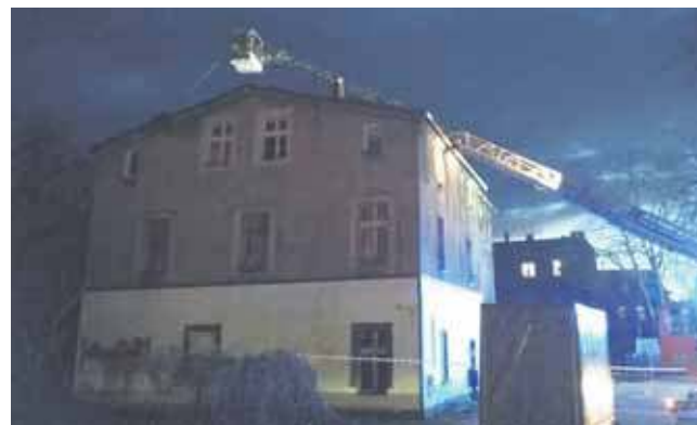
Strażacy musieli użyć drabiny i technik ratownictwa wysokościowego, aby rozebrać kominy i usunąć obłuzowane fragmenty dachu
