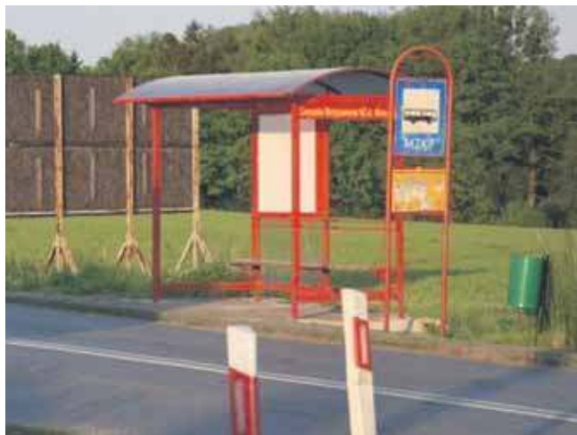
Pozbawiona szyb wiat przystankowa w Laryszowie (przy drodze Tarnowskie Góry - Zbrosławice) to niestety częsty widok. Przystanek położony z dala od zabudowań, jest szczególnie narażony na dewastację
