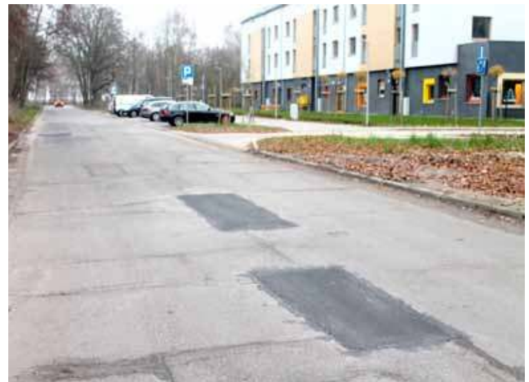
Świeże wypełnienia na Śniadeckiego wskazują, że dziury zostały załatwane
