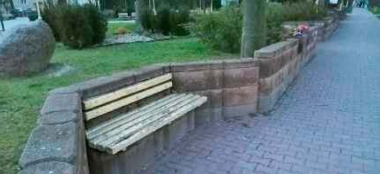
Urzędnicy zapewniają, że ławki niebawem odzyskają blask. Być może uda się również wyremontować murek
