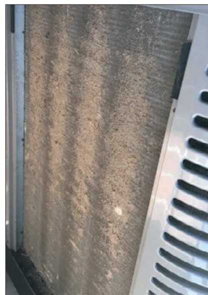
Fot. 4. Widok zanieczyszczonego wymiennika ciepła Źródło: własne autora
