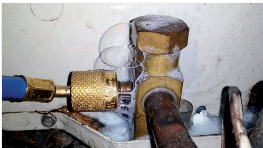
Fot. 2. Poszukiwanie i lokalizowanie nieszczelności
