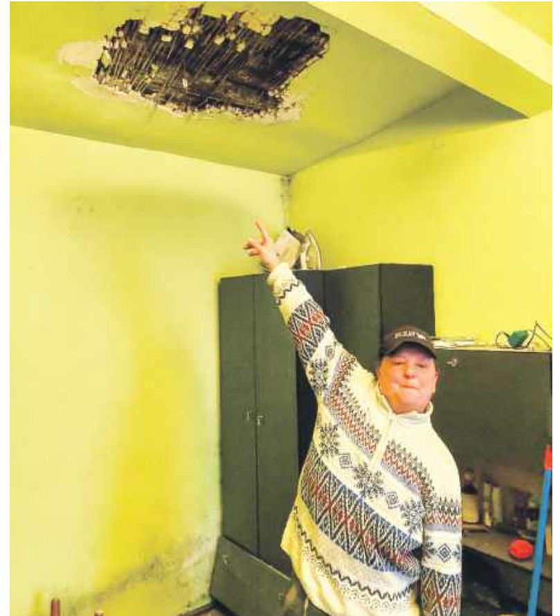
Sufit spadł na ziemię, ale pani Sabina została zapewniona, że sprawa będzie załatwiona
