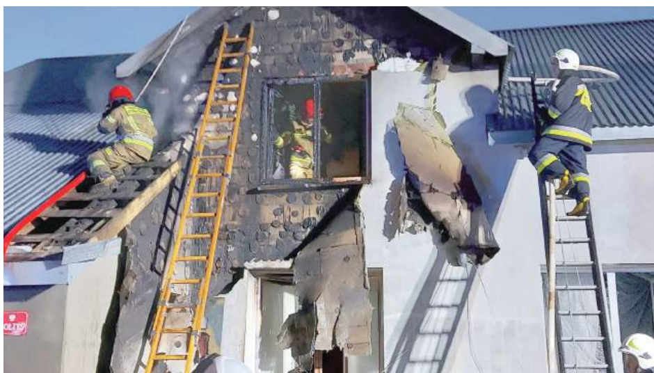
Pożar gasiły 3 zastępy PSP oraz 2 zastępy OSP KSRRG z Wóhynia i Branicy Radz. Kolonii oraz OSP Suchowla, która pierwsza pojawiła się na miejscu
