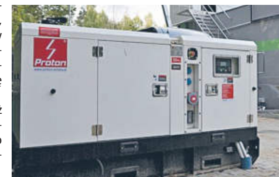
Nowoczesny, automatyczny agregat prądotwórczy Proton. Zainstalowany w oczyszczalni pozwoli jej pracować nawet w sytuacji braku energii elektrycznej w sieci energetycznej.
