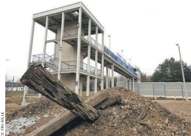
Kładka nad torami wraz z nieczynną windą oraz pozostałościami po budowie
