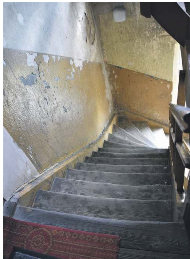
Stare drewniane schody są tak wytarte, że strach po nich chodzić. Ze ścian odpada tynk...
