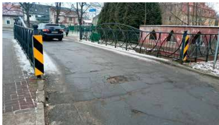
Nawierzchnia mostku również nie jest w najlepszym stanie
