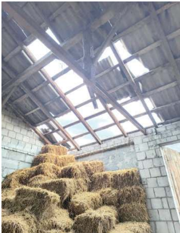
Większość zdarzeń, tj. 59, dotyczyło powalonych drzew, sześć zdarzeń uszkodzonych dachów na budynkach, cztery podtopienia oraz jeden pożar transformatora
