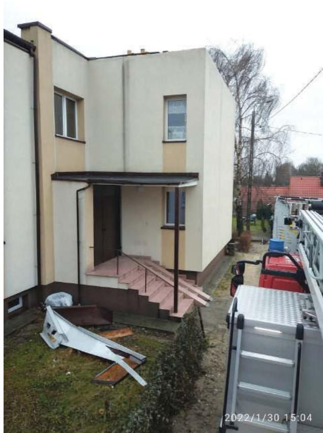
Blacha na dachu się oderwała, na szczęście nikomu nic się nie stało
