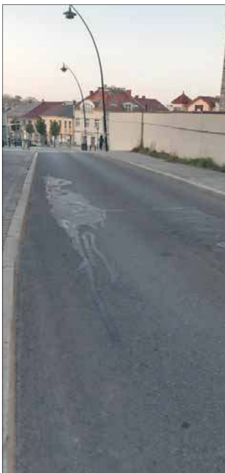
Kolejny ubytek tym razem w asfalcie
