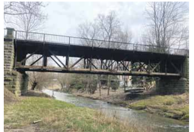
Stary most w Chabówce jest w opłakanym stanie technicznym.
