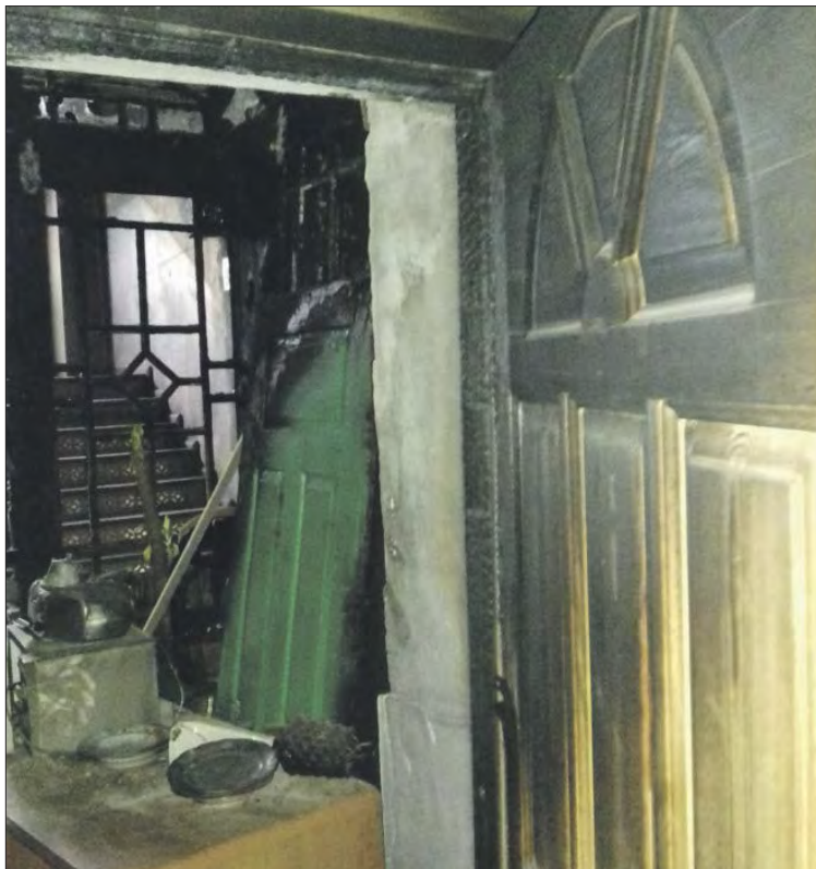
Mieszkanie zniszczone w wyniku pożaru
