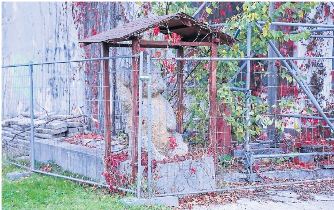
Pawilon pod Misiami. Zalecenie – wyremontować, przywrócić mu świetność
