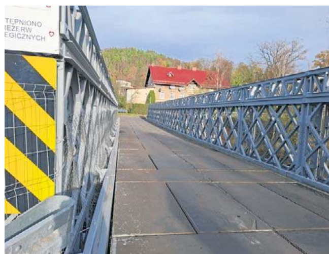
Mieszkańcy od 7 lat korzystają z mostu postawionego przez wojsko, który miał być tymczasowy...
