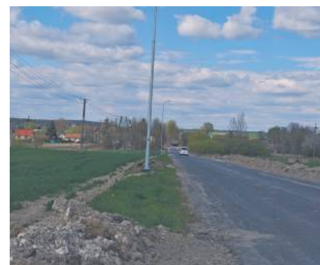
Wola Siennicka - modernizacja oświetlenia ulicznego.
