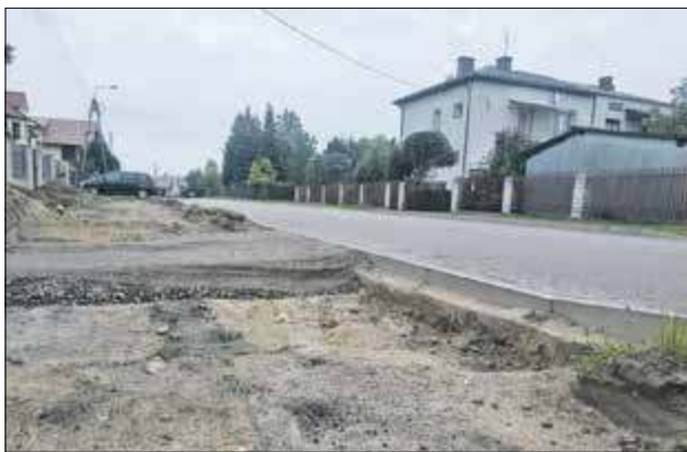
Inwestycja na ul. Kruczej stanęła zaraz po rozpoczęciu — skarżą się mieszkańcy. — Wjazdy usypano poniżej krawężników, że można uszkodzić podwozie samochodu
