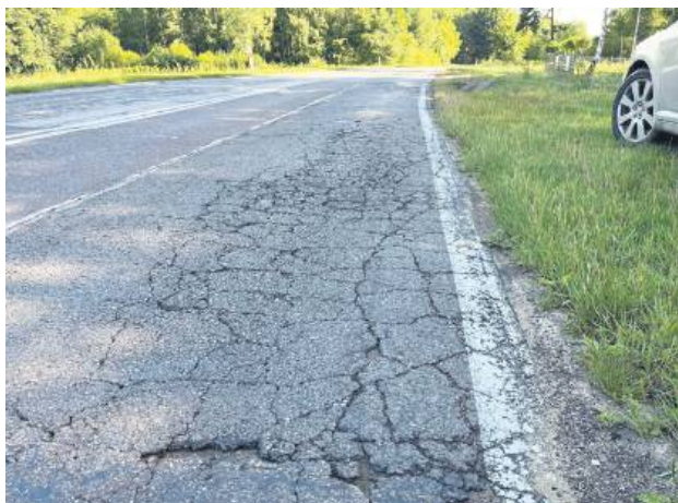
Stan drogi jest fatalny. Inwestycja zwiększy komfort i bezpieczeństwo.
