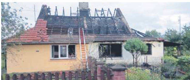
Część bliźniaka po prawej stronie uległa niemal całkowitemu spaleniu. W tej drugiej spalił się dach i poddasze. Fot. OSP Machnów Nowy
