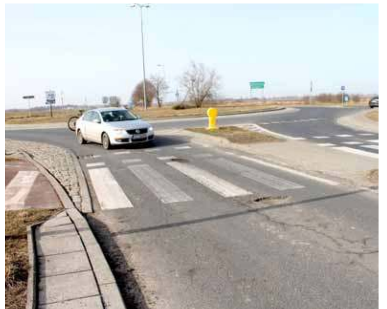
Dwie dziury na przejściu zostały już załatane
