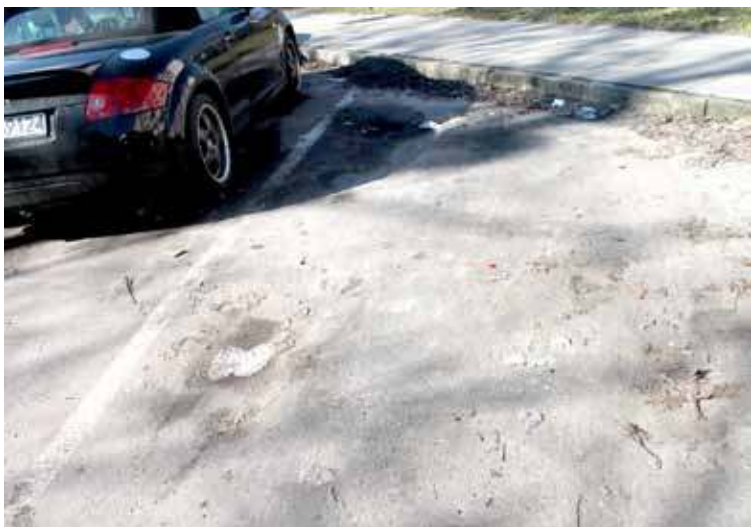
Podobnie jest na parkingu, gdzie miejscami zagrożenie stanowią szkła rozbitych butelek
