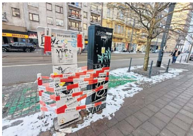
Zniszczone stacje ładowania dla pojazdów elektrycznych w Łodzi
