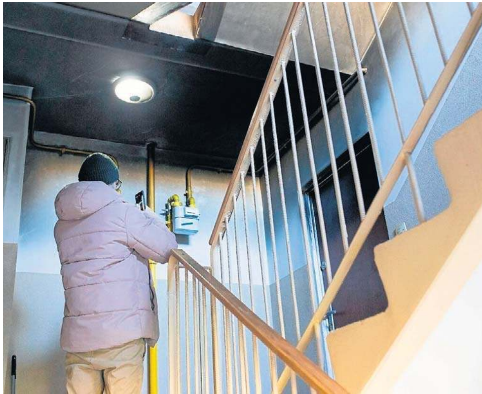
Klatka schodowa po pożarze mieszkania przy ul. Bogusława X 5, który wybuchł 8 listopada
