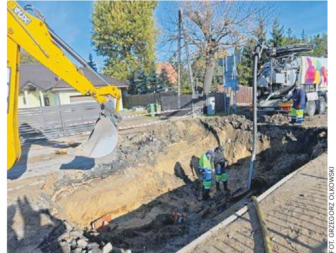
Uszkodzony odcinek rury miał sześć metrów długości
