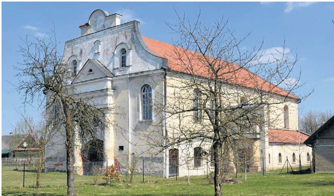
Synagoga w Orli na Podlasiu jest w bardzo złym stanie
