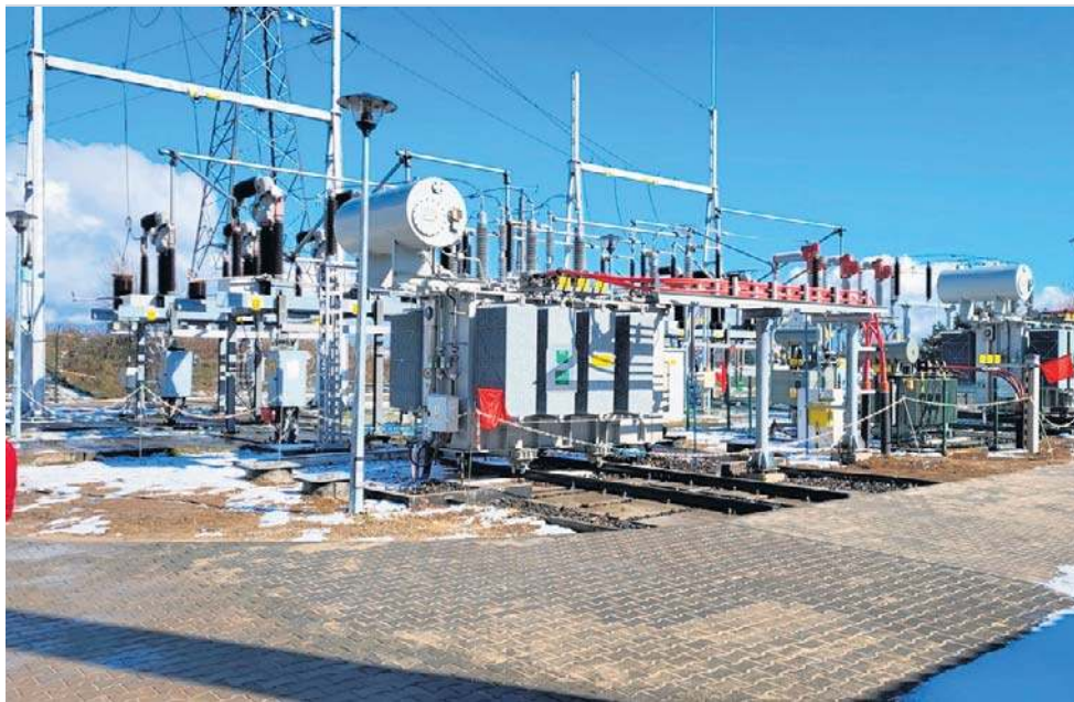
Modernizacja GPZ-ów przyniosła wzrost potencjału przyłączeniowego o 50 MW
